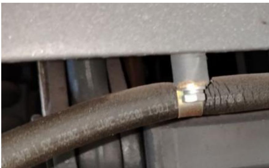
Рисунок Е.3 Образование трещин при пережатии кабеля неподходящим хомутом
